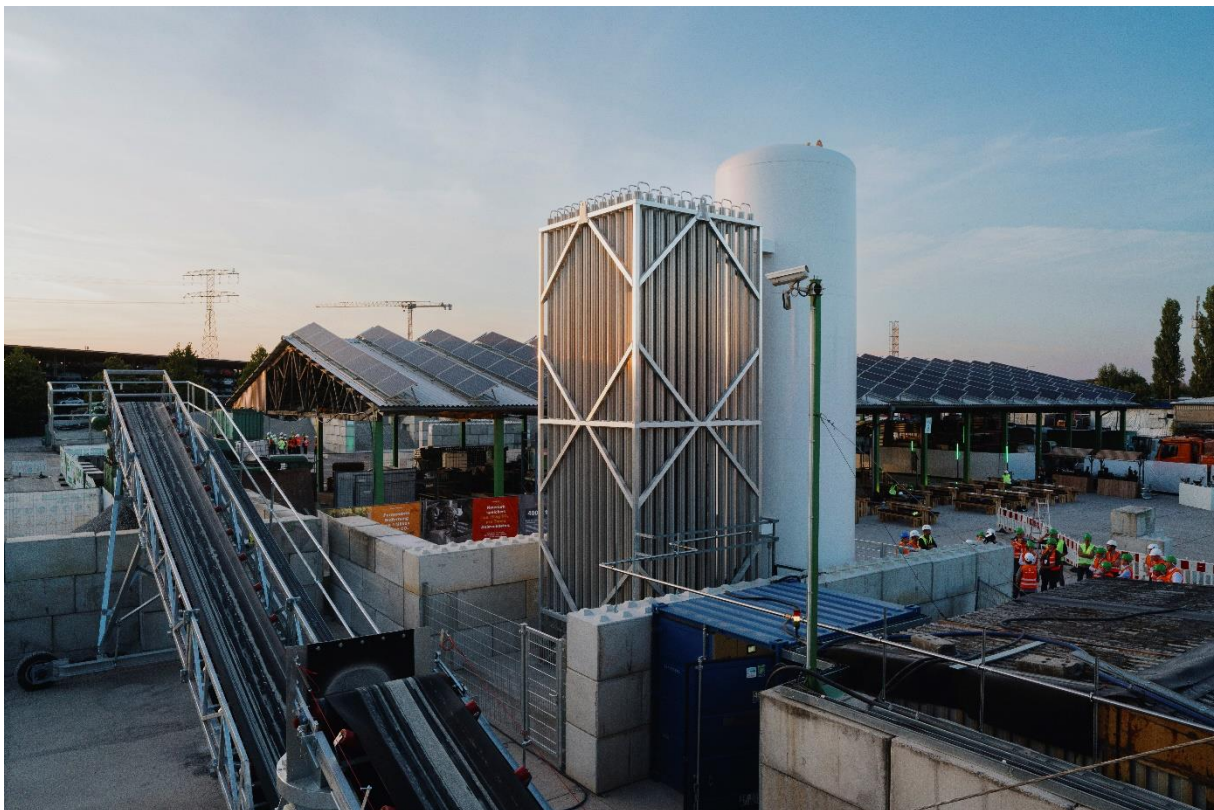
Abbildung 2 - Eine CO 2 Speicheranlage von neustark in Berlin, Deutschland, mit einer Kapazität zur Entfernung von 1'000 Tonnen CO 2 pro Jahr.
